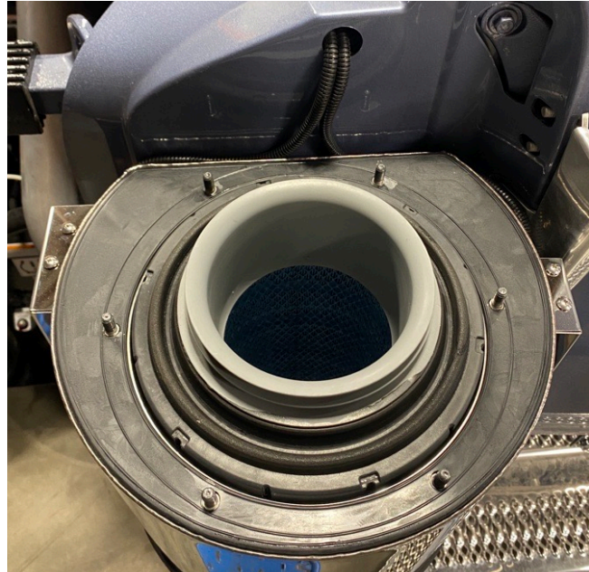
Figura 10: Mazo de cables metido entre el filtro de aire y el panel plástico (Lado del piloto mostrado)
